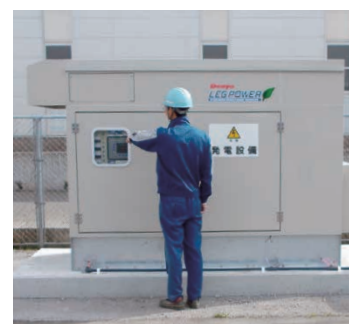
燃料センターに設置された発電設備
