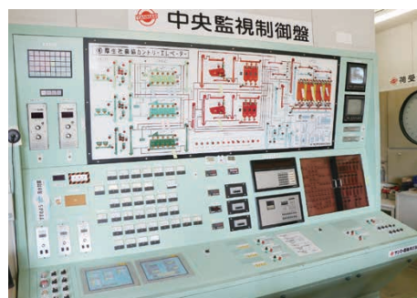
改修した主操作盤
