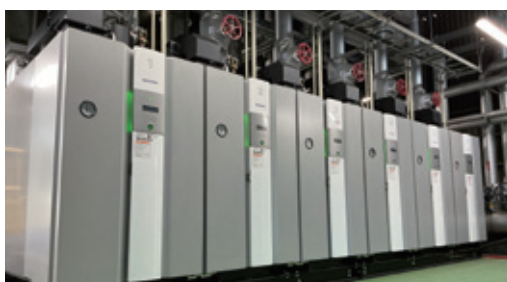
環境省の補助金を活用して導入したLNG焚き蒸気ボイラー
